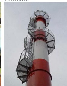
CHEMINÉE DE REFRIGÉRISSMENT, FRANCE
