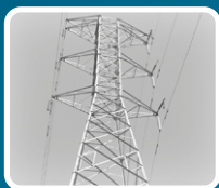
LIGNE À HAUTE TENSION
